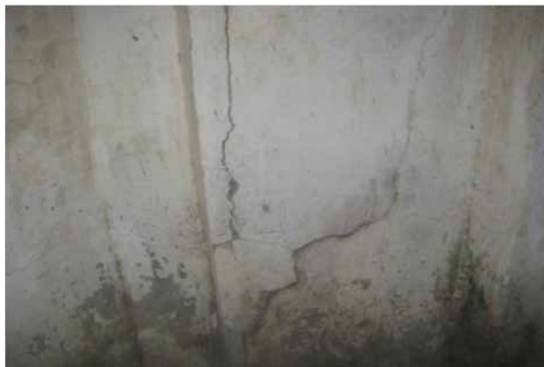
Imagen 6. Fisuras en intersección de muros. Fuente: Elaboración propia
