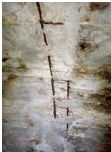
Figura 12. Revestimiento interno del embovedado con problemas fuertes de corrosión del acero y sales cristalizadas producto de la lixiviación del concreto (Mundo, 2019)
