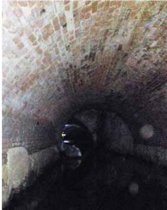
Figura 8. Vista general del embovedado de ladrillo con presencia de eflorescencias (Mundo, 2019)
